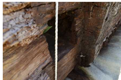
写真 12. 空洞が見られた接合部
